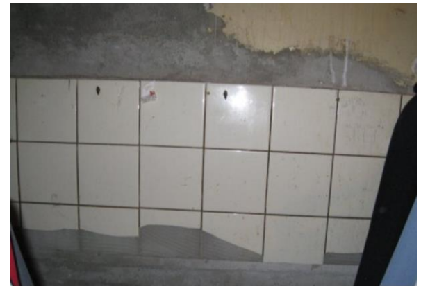
Altlasten: Platten-/Fliesenkleber mit Asbest ( http://www.bag.admin.ch/ )
